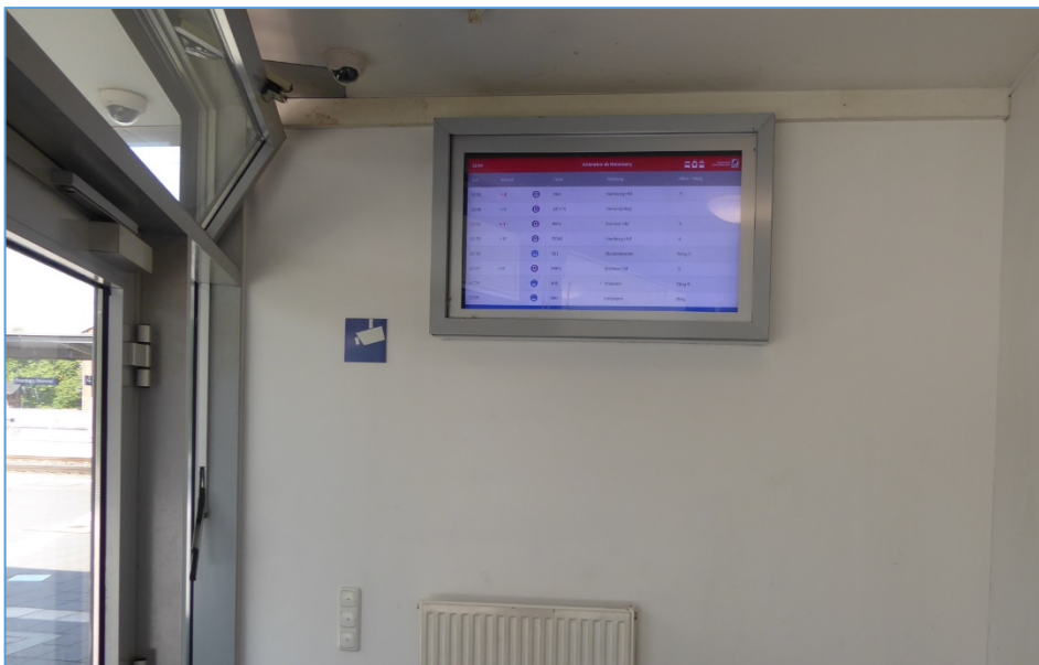
Abb. C-17: Im Warteraum des Bahnhofs Rotenburg wurde ein Abfahrtsmonitor installiert, der über die aktuellen Zug- und Busabfahrten informiert. (Foto ZVBN)
