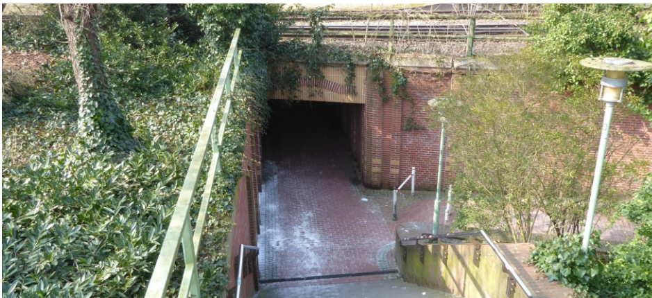
Abb. A-10: Die Zugangsbereiche zum südlichen Bahnhofstunnel in Verden (Aller) vermitteln einen etwas vernachlässigten Eindruck. (Quelle: ZVBN)
