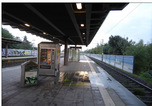
Abbildung 15: Das Bahnsteigdach an Gleis 3 in Delmenhorst ließ, wie schon vor zwei Jahren, an mehreren Stellen Regenwasser auf den Bahnsteig laufen.
