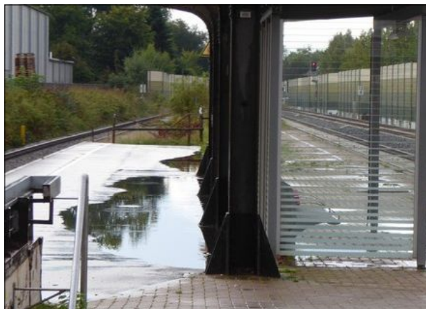
Abb. 10: Große Bereiche des Mittelbahnsteigs in Rastede waren nach Regenfällen geradezu überflutet (bis zu 8 cm tiefe Pfützen).
