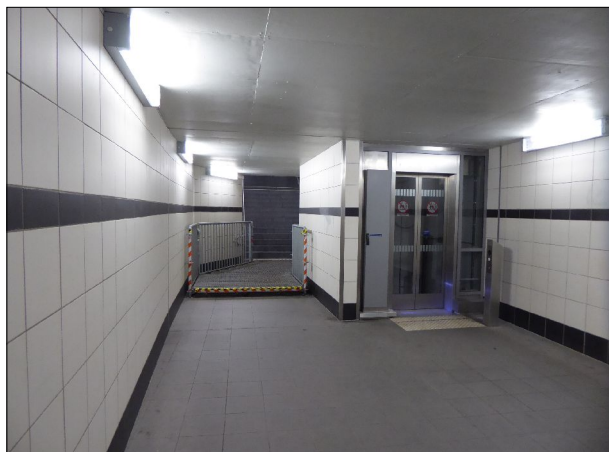
Abb. 44: In Kirchweyhe wurde im modernisierten Tunnel vor der Bahnsteigtreppe ein Gitterpodest eingebaut, um sich dort sammelndes Regenwasser zu überbrücken.
