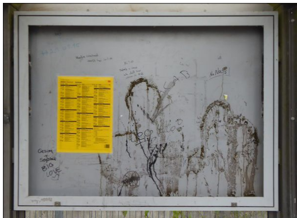
Abb. 31: Der Zustand der Informationsvitrine im Fahrgastunterstand in Huntlosen an Gl. 2 lässt zu wünschen übrig. Zwar hängt ein Fahrplan aus, doch da die Scheibe fehlt, ist eine Erneuerung der Vitrine dringend erforderlich.
