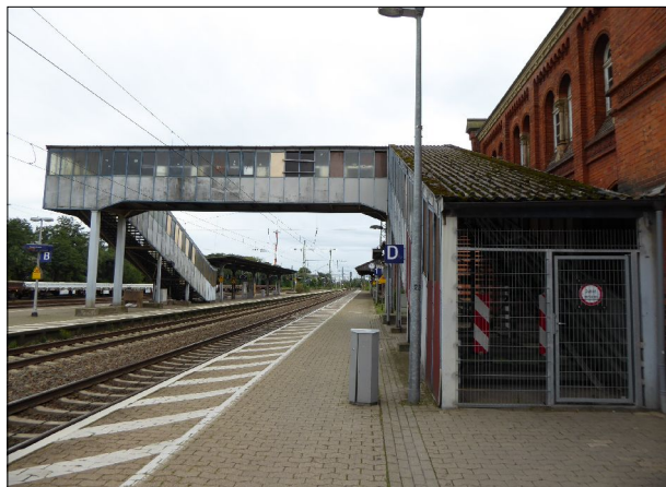
Abb. 52: Die längst entbehrliche und geschlossene Fußgängerüberführung in Diepholz sollte bereits vor Jahren zurückgebaut werden. Die Beeinträchtigung des Erscheinungsbildes ist nicht zu übersehen.
