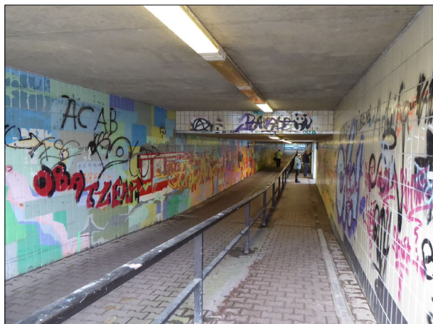
Abb. 43: Das Modernisierungsprogramm für den Bahnhof Ottersberg beschränkte sich auf den neuen Mittelbahnsteig samt Ausgang. Die Unterführung zeigt sich weiterhin in einem unansehnlichen Zustand und mit teilweise defekter Beleuchtung.
