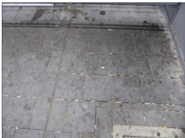
Abb. 11: Die Oberfläche des neuen Hausbahnsteigs in Syke war unter dem Dach verschmutzt. Auffällig waren die vielen Zigarettenkippen in den Fugen zwischen den Platten.
