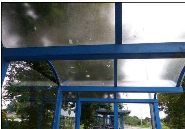
Abb. 18: Die Dachelemente des Unterstands in Sellstedt waren an mehreren Stellen angekokelt.
