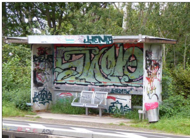
Abbildung 13: Dieser Unterstand in Bramstedt war stark beschmiert und beschädigt. Im Zuge der bereits begonnenen Bahnsteigerneuerung wird er jedoch bald ersetzt.
