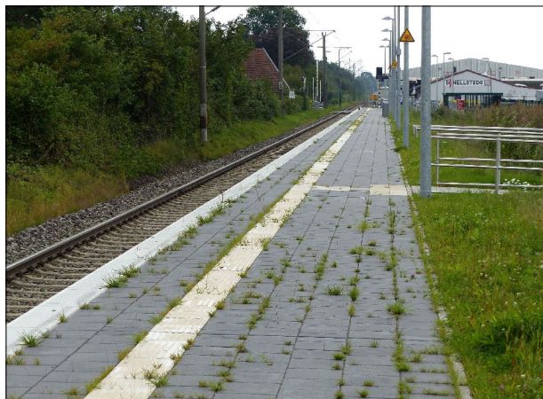
Abb. 9: Bereits einen Sommer nach Inbetriebnahme der Station zeigt sich ein erheblicher Grünwuchs auf dem Bahnsteig in Kirchhammelwarden.
