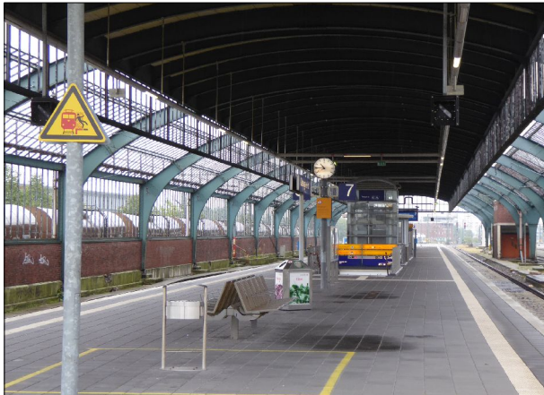
Abb. 16: Die Bahnsteighalle in Oldenburg Hbf zeigt sich aufgrund fehlender Scheiben sowie undichter Stellen im Bereich der noch vorhandenen Dacheindeckungen in einem unverändert schlechten Zustand.
