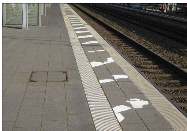
Abb. 12: Auf dem Mittelbahnsteig Gleis 2/3 in Achim löst sich die nachträglich aufgebrachte Markierung des Gefahrenbereiches für Schnelldurchfahrten.
