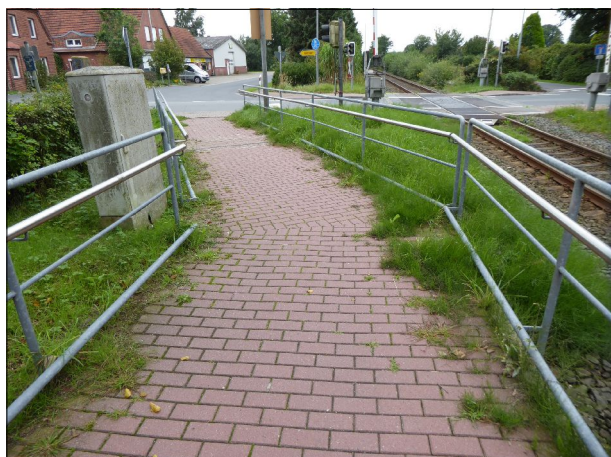
Abb. 41: Der Bahnsteigzugang in Brettorf wird zunehmend von Grünbewuchs eingenommen und bedarf einer Entkrautung.
