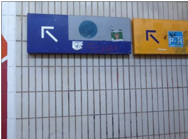
Abb. 28: Viele Wegeleitungsschilder in den Ausgängen des Tunnels von Hude sind bekratzelt oder beklebt und teilweise dadurch unkenntlich.
