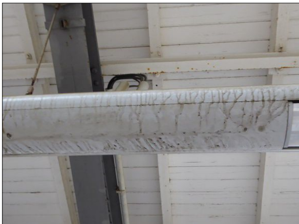
Abb. 48: Die Lichtleisten unter den Bahnsteigdächern in Verden waren verschmutzt.
