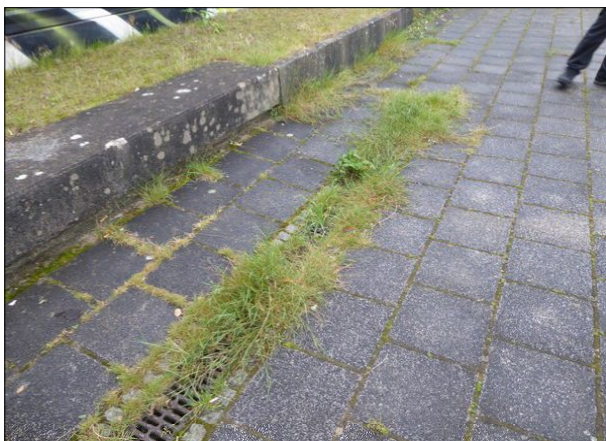
Abb. 12: Diese Wasserablauffrinne auf dem Bahnsteig an Gleis 1 in Delmenhorst ist stark bewachsen.
