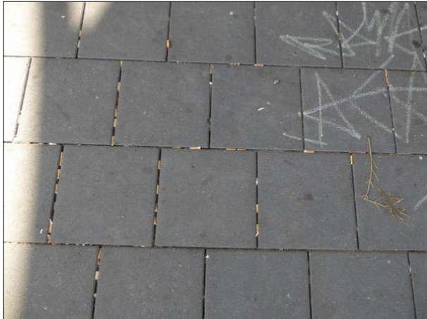
Abb. 11: In Brake waren auf dem Hausbahnsteig viele Zigarettenkippen in den Fugen zwischen den Platten.
