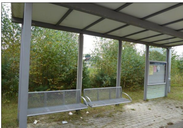
Abbildung 15: Vier Scheiben fehlten in Visselhövede im Unterstand an Gleis 2. Zudem lag Abfall unter den Bänken.
