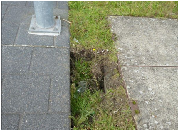
Abb. 10: Neben dem Bahnsteig an Gleis 2 in Ahlhorn sind durch Erdabsackungen an mehreren Stellen Löcher entstanden.
