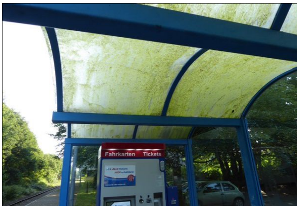
Abb. 18: Das Dach des Unterstands in Sellstedt war verschmutzt und an einzelnen Stellen angekokelt.
