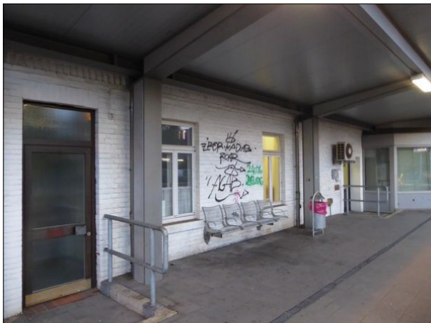
Abb. 17: Im Wartebereich unter dem Vordach war die Fassade des Empfangsgebäudes von Achim beschmiert.
