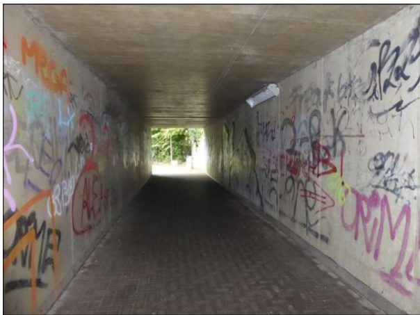
Abb. 44: Der Tunnel zwischen den beiden Bahnsteigzugängen in Dreie war erneut stark beschmiert. Neu war jedoch, dass die einzige Leuchte zerstört wurde.
