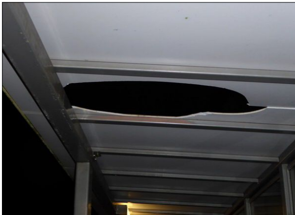
Abb. 16: Das Dach des Unterstands an Gleis 1 in Etelsen war beschädigt. Das Loch war rund einen Meter lang und 40 cm breit. Solche Schäden sind jedoch sehr selten.
