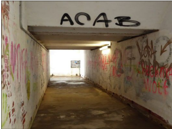
Abb. 43: Die Unterführung des Bahnhofs Visselhövede weist zahlreiche Mängel auf. Sie ist umfangreich beschmiert, die Gleiströge sind undicht. Zudem sind die Oberlichter beschädigt und verschmutzt.
