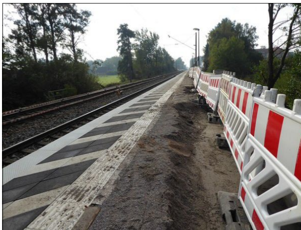
Abb. 8: Die Baustellenabspernung in Hoykenkamp war an Gleis 1 bereichsweise erst hinter der Absturzkante aufgestellt.
