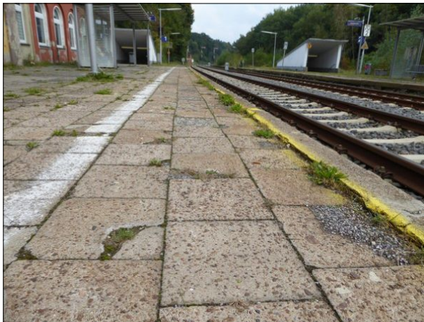
Abb. 7: Die Bahnsteige in Visselhövede weisen Schäden, Absackungen, Unebenheiten und Verkrautungen auf. Der Bahnhof macht insgesamt einen vernachlässigten Eindruck.
