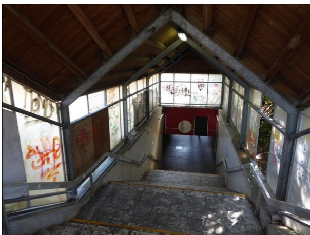
Abb. 45: Zwar wetterfest aber doch alles andere als einladend ist dieser Tunnelzugang in Hude.
