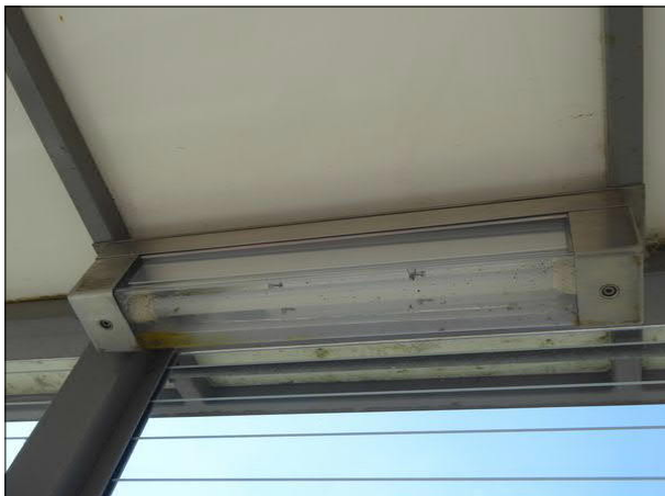
Abbildung 44: Diese Leuchte eines Unterstands in Bremen Turnerstraße war innen mit Insekten verschmutzt. Außerdem hatte sich in der Leuchtenhaube etwas Wasser gesammelt.
