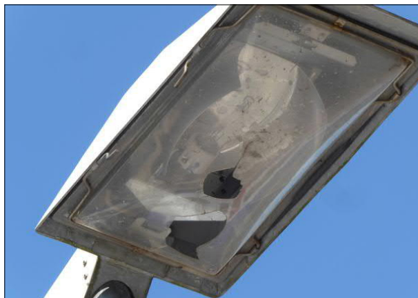
Abbildung 39: In Bremerhaven-Lehe waren neben einzelnen Dachleuchten auch zwei Hauben an Lichtmasten der Bahnsteigbeleuchtung beschädigt.
