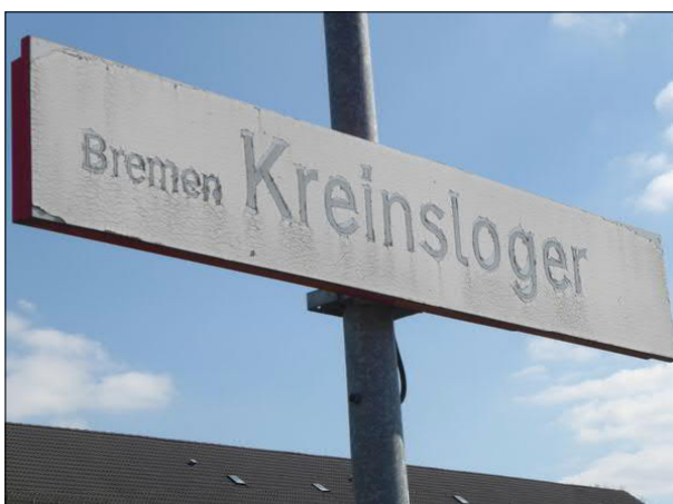
Abbildung 21: An einigen Bahnhofnamensschildern im Bereich der FVE blättern die Beschriftungsfolien ab. Auch der Kontrast zwischen Schrift und Hintergrund nimmt ab.
