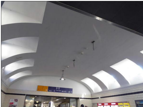
Abbildung 37: In Bremerhaven Hbf fehlten an der Decke im Vorraum des Bahnsteigtunnels zwei Strahler.
