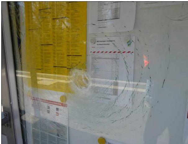
Abbildung 26: Die Scheibe der Vitrine im Unterstand von Bremerhaven-Wulsdorf war stark beschädigt.
