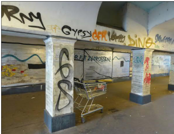
Abbildung 35: Das Erscheinungsbild der Fußgängerunterführung am Bahnhof Bremen-Sebaldsbrück wird durch Schmierereien und Verschmutzungen zunehmend schlechter. An einzelnen Stellen tropft wieder Wasser aus der Tunneldecke.
