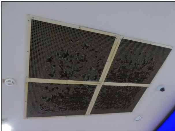
Abbildung 29: Im Seitenflügel vor dem Reisezentrum des Hauptbahnhofs in Bremen war das Lüftungsgitter an der Decke verschmutzt.
