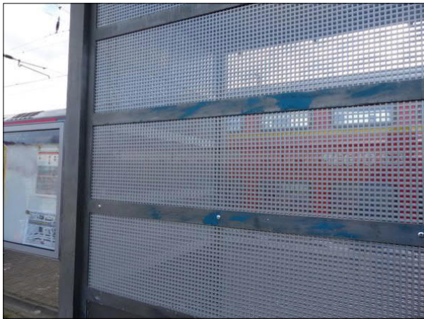
Abbildung 11: Um mutwillige Zerstörungen einzudämmen, wurden einige Scheiben des Fahrgastunterstands in Bremen-Walle mit Lochblech verkleidet.
