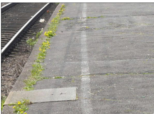
Abbildung 9: Der Bahnsteig in Bremen-Neustadt weist auf ganzer Länge und Breite Oberflächenschäden auf. Zudem gibt es stellenweise kleine Schäden an den Bahnsteigkanten.
