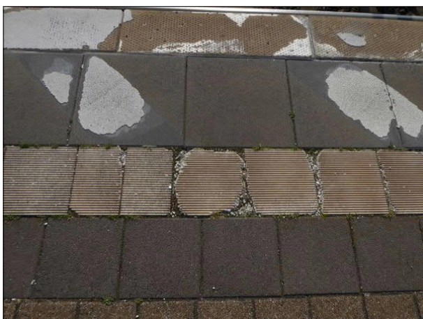
Abbildung 45: Die Platten des Blindenleitstreifens und die Gefahrenbereichsmarkierung auf dem Bahnsteig in Bremen-Walle sind bereichsweise beschädigt.
