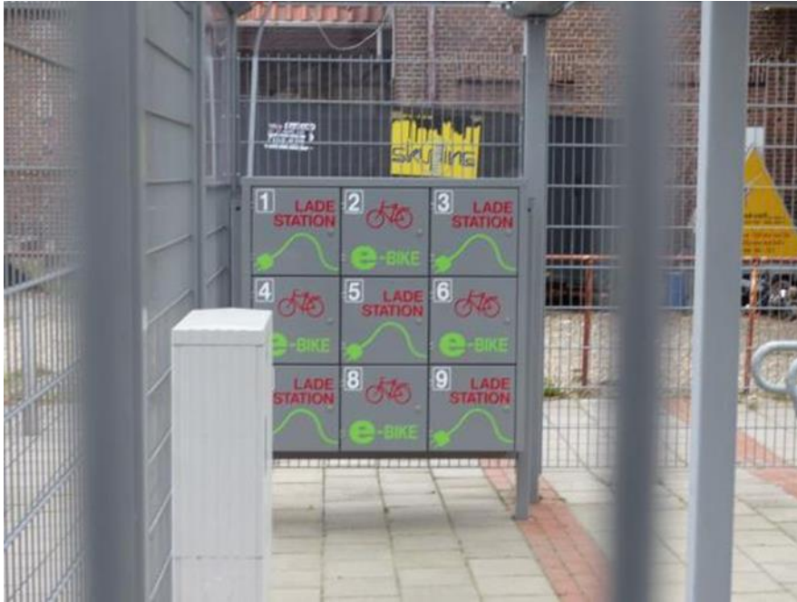
Abbildung 9 B+R Bahnhof Bremerhaven-Lehe Pedelec-Ladestation
